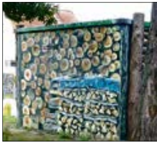
Einem Brennholzstapel zum Verwechseln ähnlich sieht diese Pumpstation aus, die sich auch noch an einen echten Baum anzulehnen scheint.
